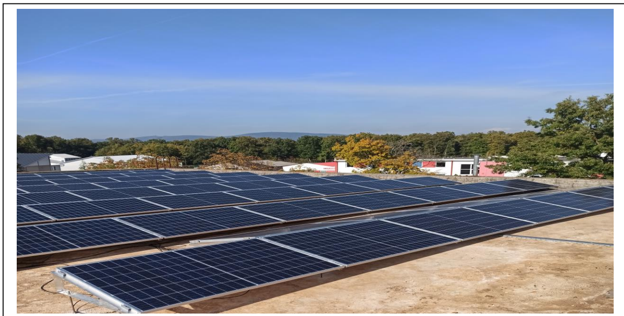
60 kW teljesítményű napelemes rendszer
